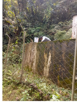
Fotografía 8. Tanque de almacenamiento y medición de caudal en tubería de ingreso
