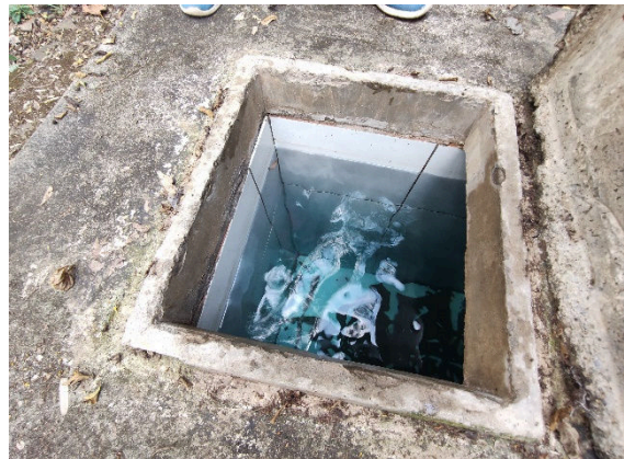
Fotografía 4. Tanque de almacenamiento con revestimiento interno de cerámica
