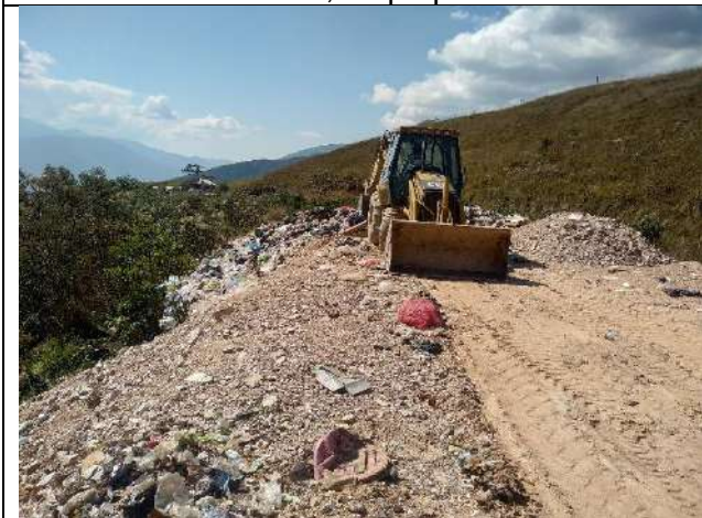
Coroico 15/08/2019 Relleno Sanitario
