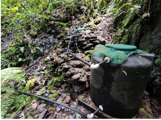
Fotografía 1. Captación del sistema de agua de la comunidad
