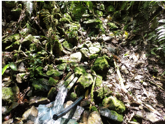
Fotografía 3. Vista de tuberías de captación y área de aporte, sitio de muestro y medición de caudal
