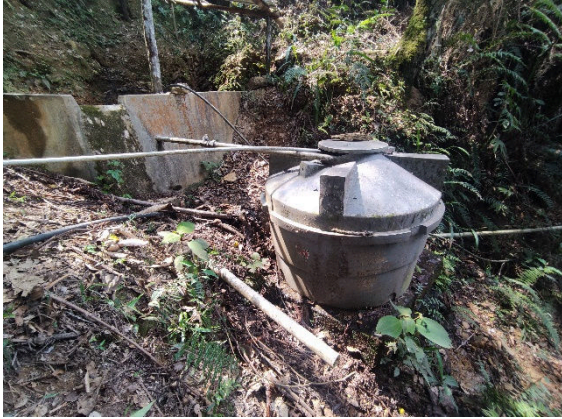
Fotografía 1. Tanque de captación de 2 fuentes de la comunidad
