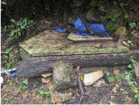
Fotografía 1. Obra de captación del sistema de agua de la comunidad
