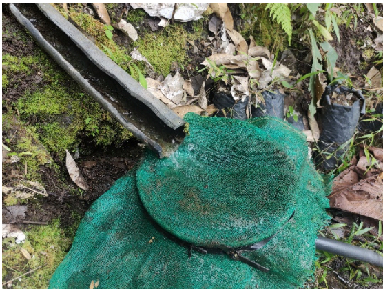
Fotografía 3. Captación y malla para retención de sólidos
