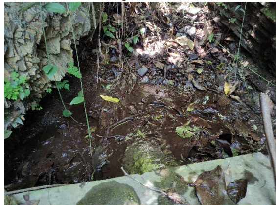
Fotografía 4. Retención de sólidos y restos de vegetación
