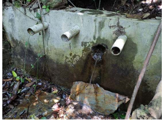
Fotografía 2. Muro de retención de sólidos y material de arrastre previo ingreso a cámara
