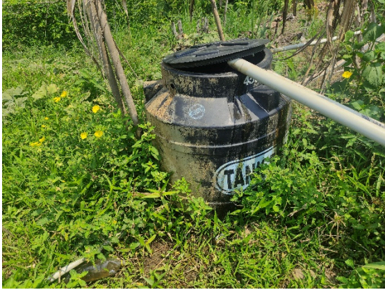
Fotografía 1. Tanque plástico de captación de varias fuentes
