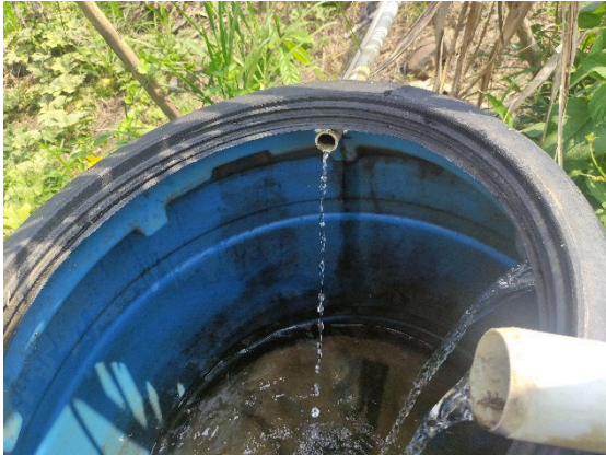
Fotografía 3. Tuberías de ingreso de varias fuentes a tanque
