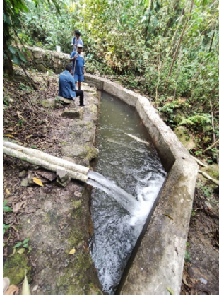
Fotografía 1. Obra de captación del sistema de agua de la comunidad
