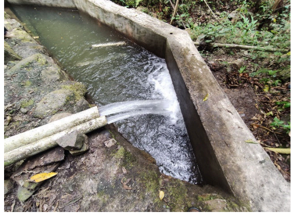
Fotografía 2. Captación de agua a través de tuberías, sitio de medición de caudal
