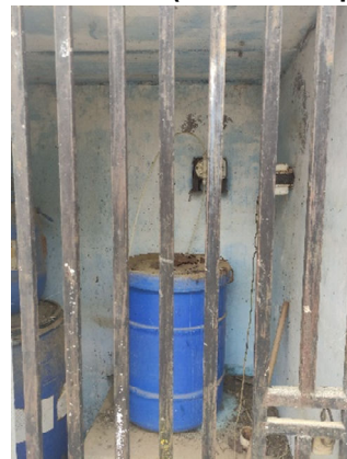
Fotografía 6. Caseta de hipoclorador en tanque de almacenamiento (no está en operación)
