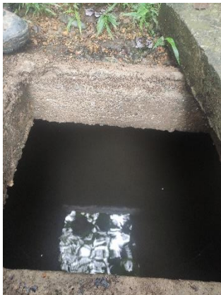
Fotografía 3. Vista del agua al interior de una cámara
