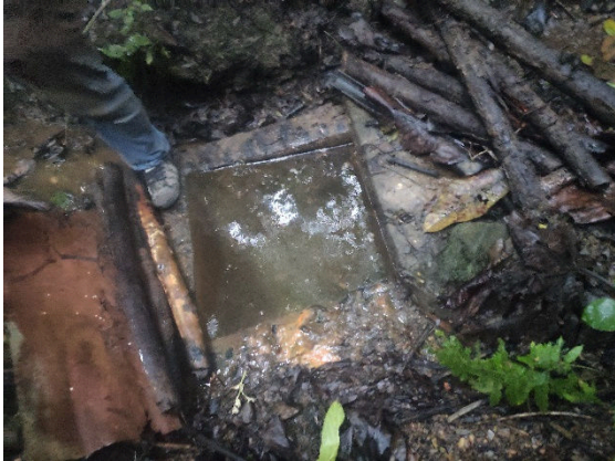
Fotografía 7. Cámara de captación saturada por retención de sólidos (foto de archivo en visita previa, julio 2024)
