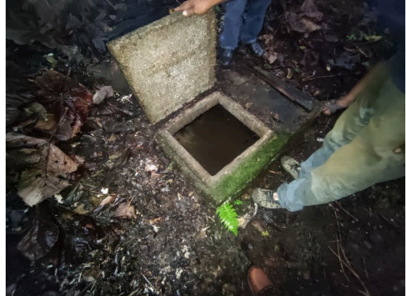
Fotografía 8. Vista del agua en cámara de captación (foto de archivo en visita previa, julio 2024)
