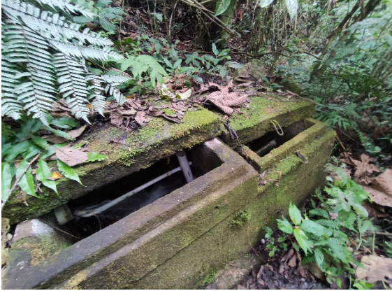
Fotografía 3. Cámara de captación de fuente 2
