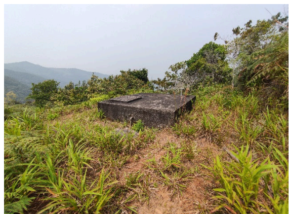
Fotografía 6. Tanque de almacenamiento
