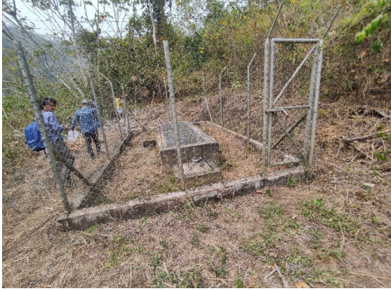
Fotografía 1. Estructura hidráulica del sistema de agua de la comunidad
