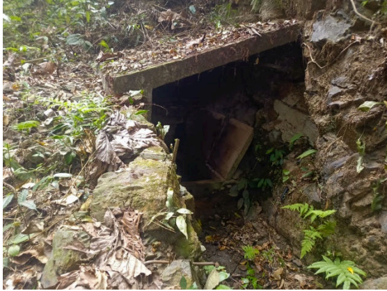
Fotografía 1. Obra de captación del sistema de agua
